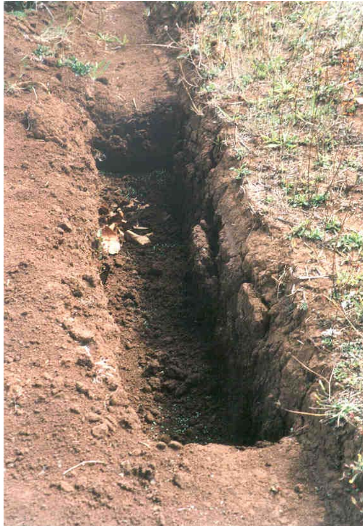
Figura 15. Zanjaz de Infiltración con problemas relación Talud.
