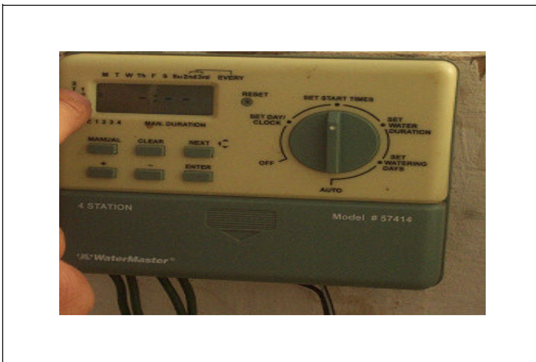
FIGURA 4. Vista del programador de riego utilizado para cada parcela
